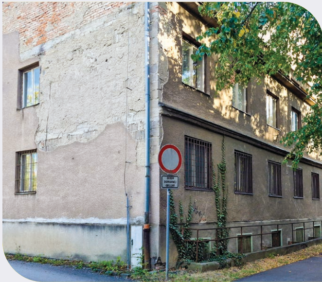
Pôvodná budova v dezolátnom stave.
